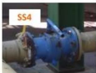
1/ Remplacement d'un joint fuyard sur bride peinture amiantée
