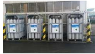
Dispositif centralisé Distribution Source OPPBTP
