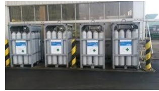
Dispositif centralisé Distribution Source OPPBTP
